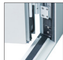
Seuil PMR à rupture de pont thermique
